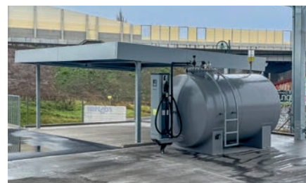
Die überdachte Blackout-Tankstelle.
